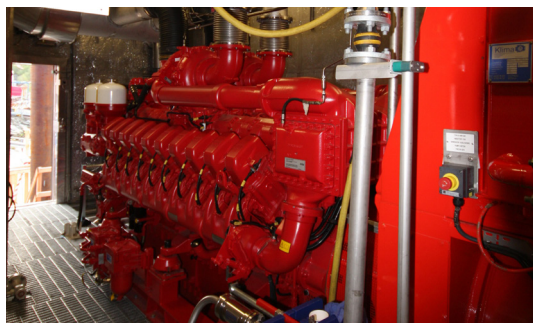
Vier 4000er MTU-Motoren mit je 20 Zylindern und 2.800 Kilowatt treiben die Pumpen an.
