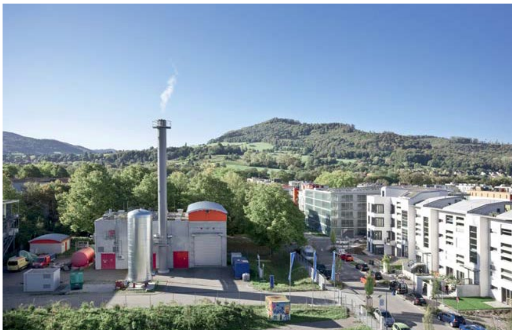
Blockheizkraftwerke kommen als effiziente und unabhängige Energielieferanten in vielen Anwendungen weltweit zum Einsatz.
